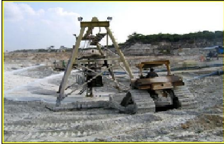
Foto 1 Tambang Semprot Pada Cadangan Dangkal Bahan Galian Timah Di Wilayah Pertambangan PT.Koba Tin
